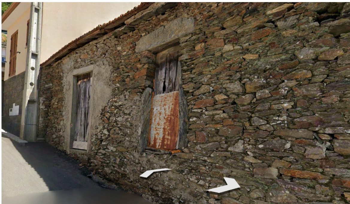
Figura 2. Exemplificação de edifícios degradados – Calçada do Cemitério
