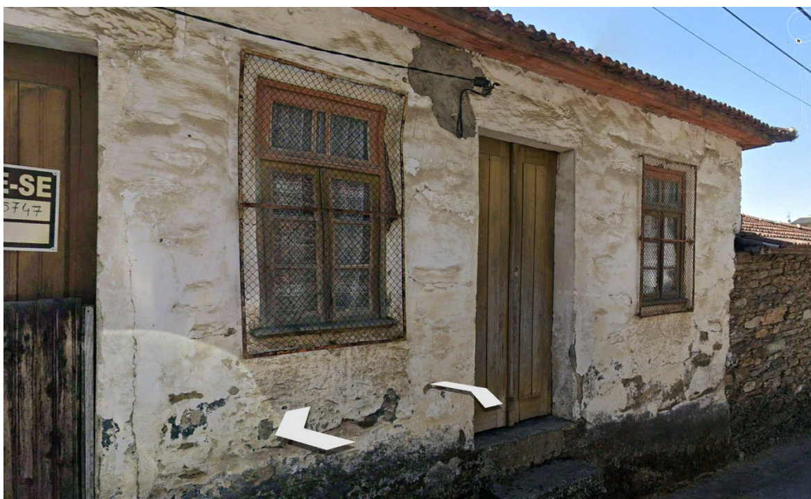
Figura 3. Exemplificação de edifícios degradados – CM 1308
