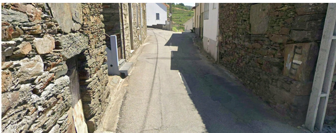
Figura 4. Exemplificação de piso degradado na ARU de Vinhós – Rua de Eiro
