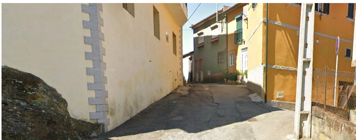
Figura 2. Exemplificação de piso degradado na ARU de Seara – CM 1323
