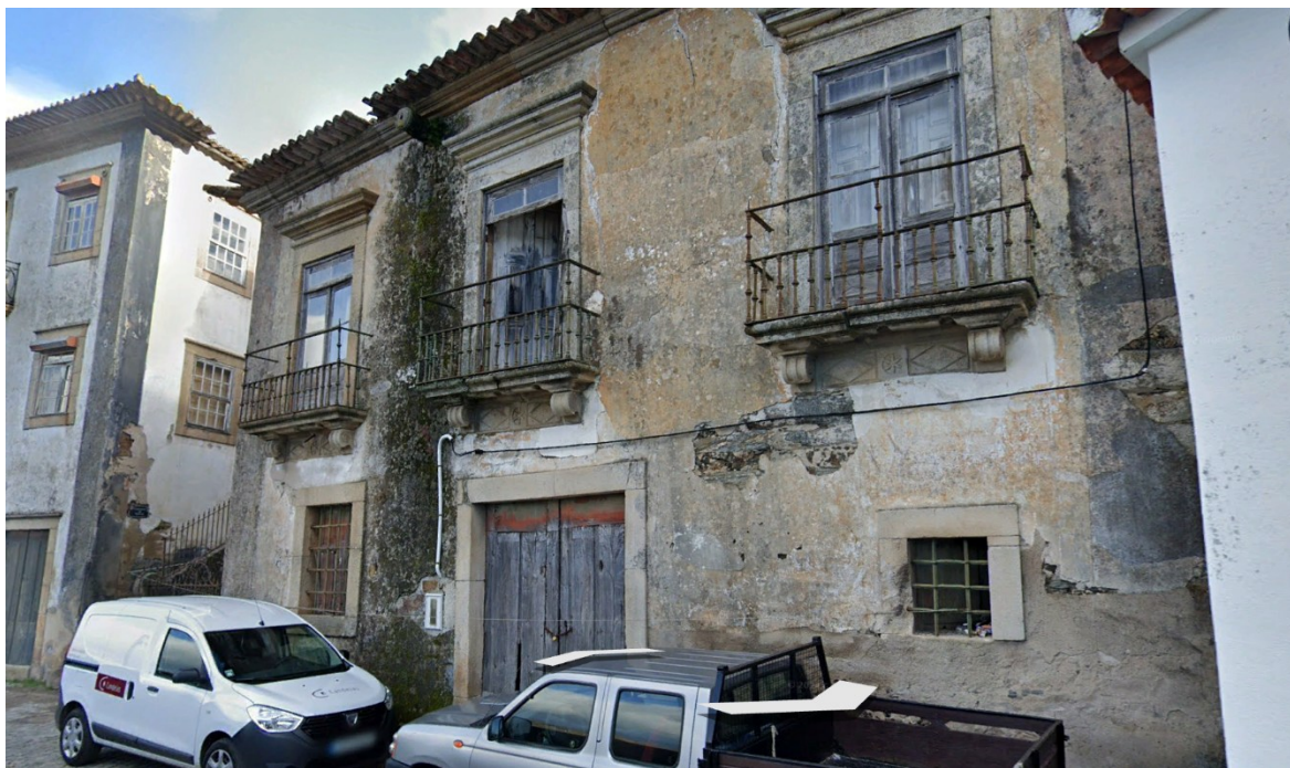
Figura 4. Exemplificação de edifícios degradados – Rua do Vale
