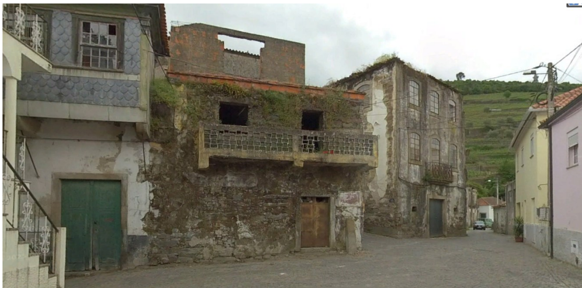
Figura 2. Exemplificação de edifícios degradados – Rua do Fundo do Povo
