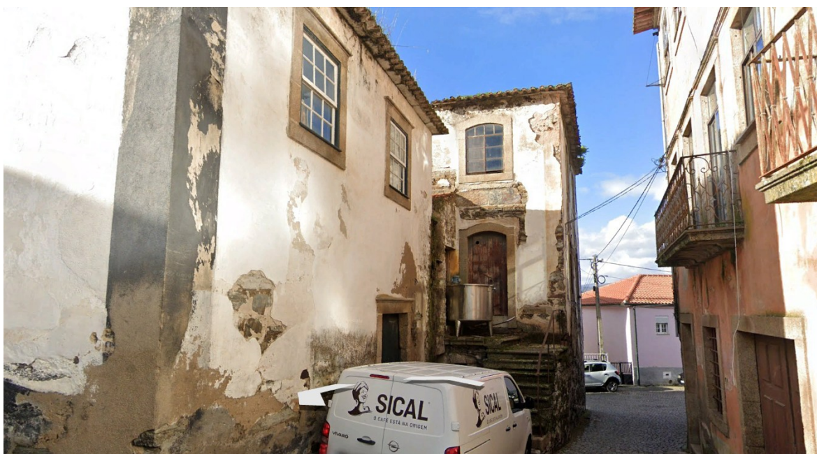
Figura 3. Exemplificação de edifícios degradados – Largo do Eiro
