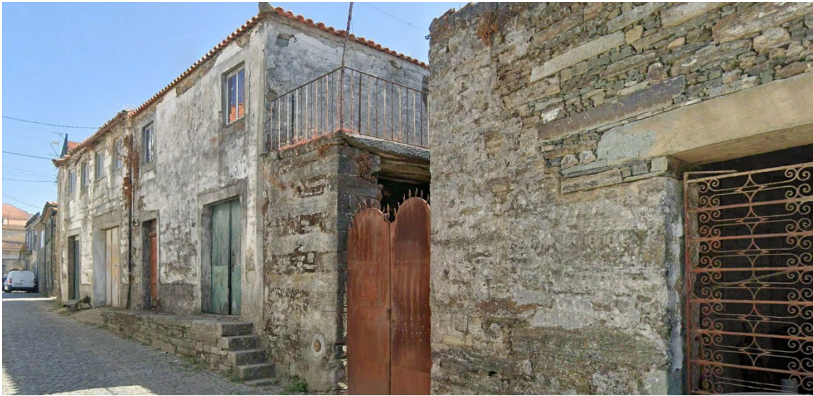
Figura 2. Exemplificação de edifícios degradados – EM 593
