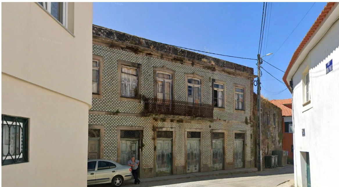
Figura 3. Exemplificação de edifícios degradados – Rua São João Bosco
