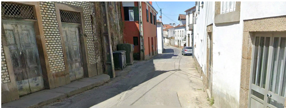
Figura 4. Exemplificação de piso degradado na ARU de Poiares – EM 593
