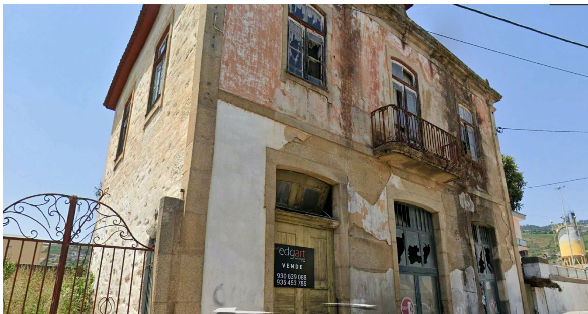
Figura 2. Exemplificação de edifícios degradados – Rua do Comendador Joaquim Macedo
