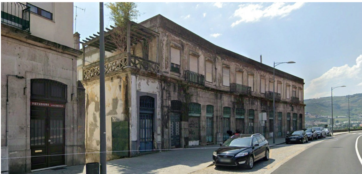
Figura 4. Exemplificação de edifícios degradados – Rua José Vasques Osório
