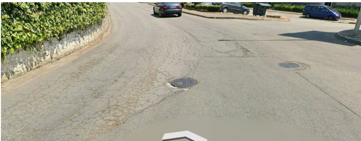
Figura 5. Exemplificação de piso degradado na ARU de Peso da Régua e Godim – EM 601
