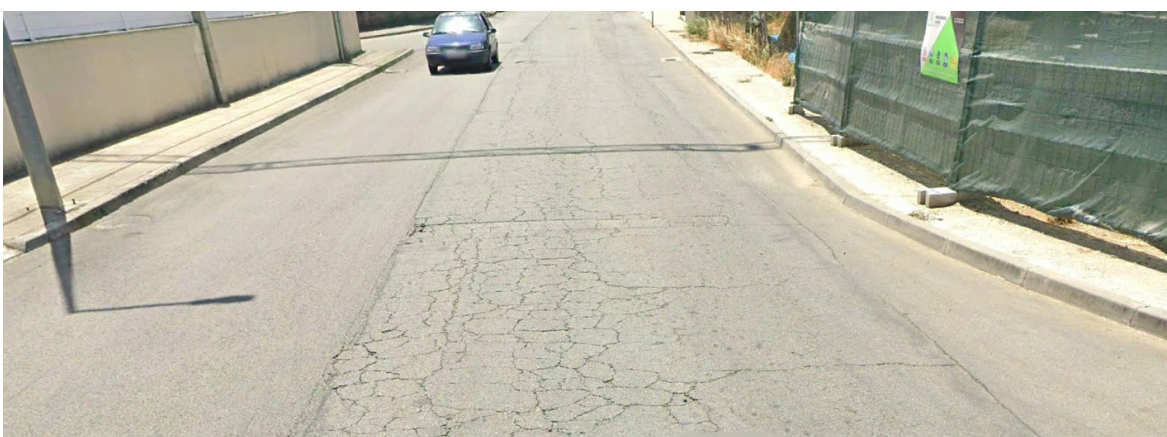
Figura 6. Exemplificação de piso degradado na ARU de Peso da Régua e Godim – Rua Camilo de Araújo Correia
