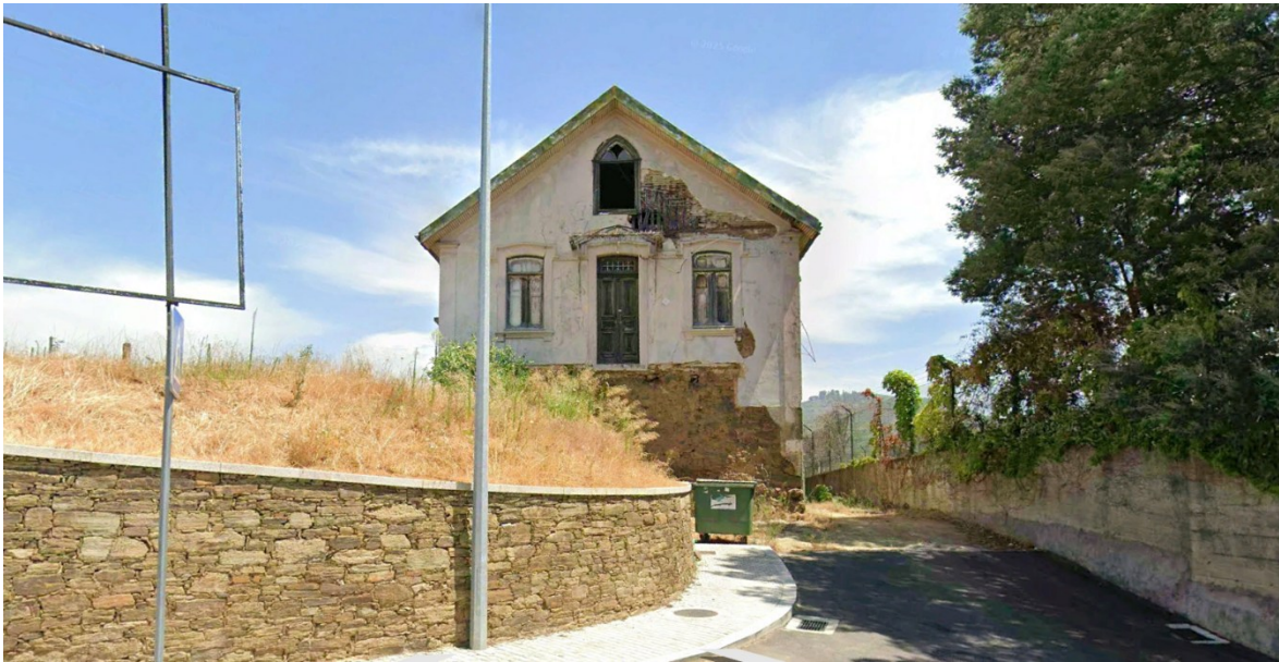
Figura 3. Exemplificação de edifícios degradados – Rua Camilo Araújo Correia
