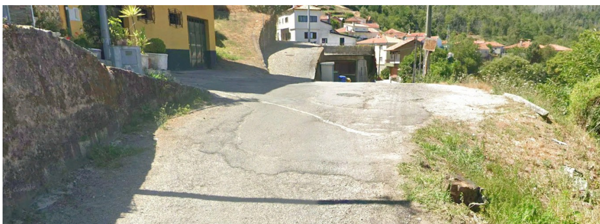
Figura 4. Exemplificação de piso degradado na ARU de Passos – CM 1309
