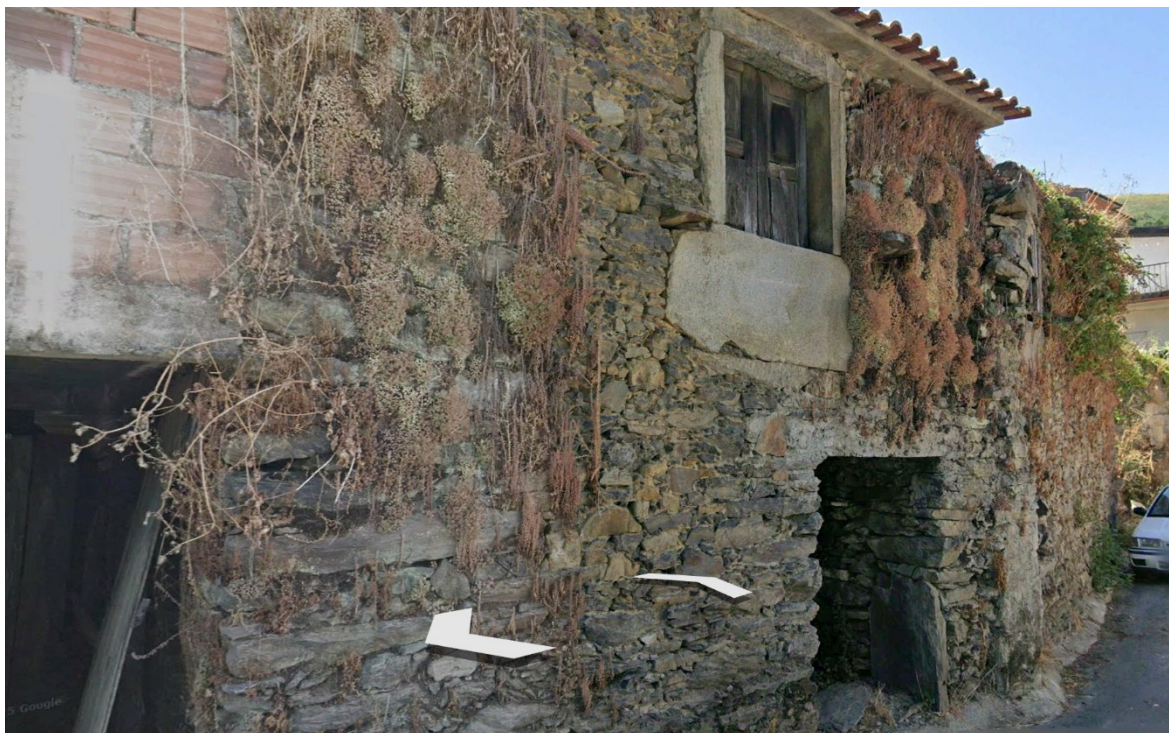
Figura 2. Exemplificação de edifícios degradados
