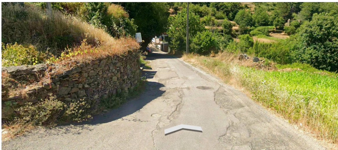
Figura 5. Exemplificação de piso degradado na ARU de Passos – CM 1309
