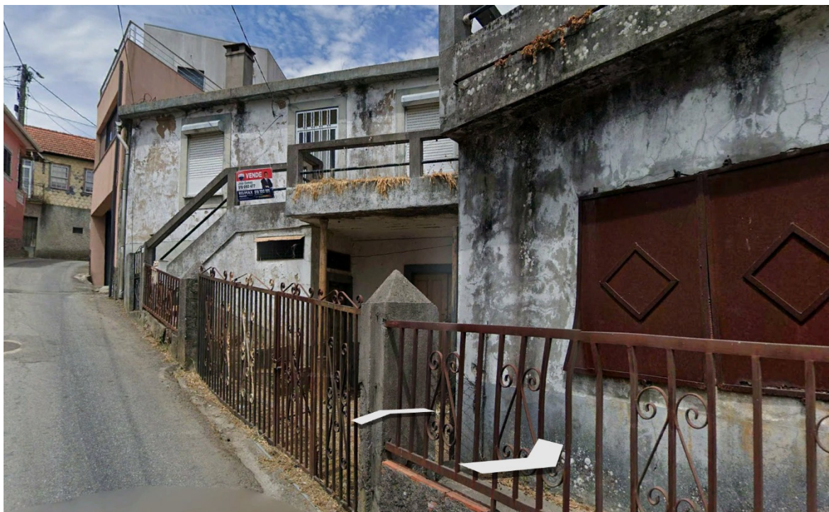
Figura 2. Exemplificação de edifícios degradados - CM 1312
