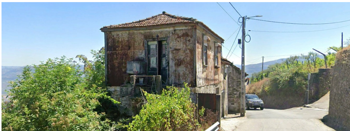
Figura 4. Exemplificação de edifícios degradados – Rua do Barco
