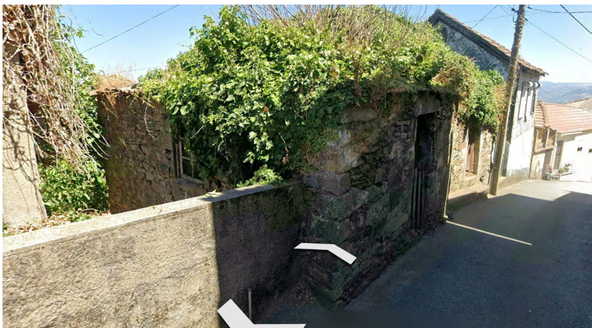
Figura 3. Exemplificação de edifícios degradados – Rua de Marvão
