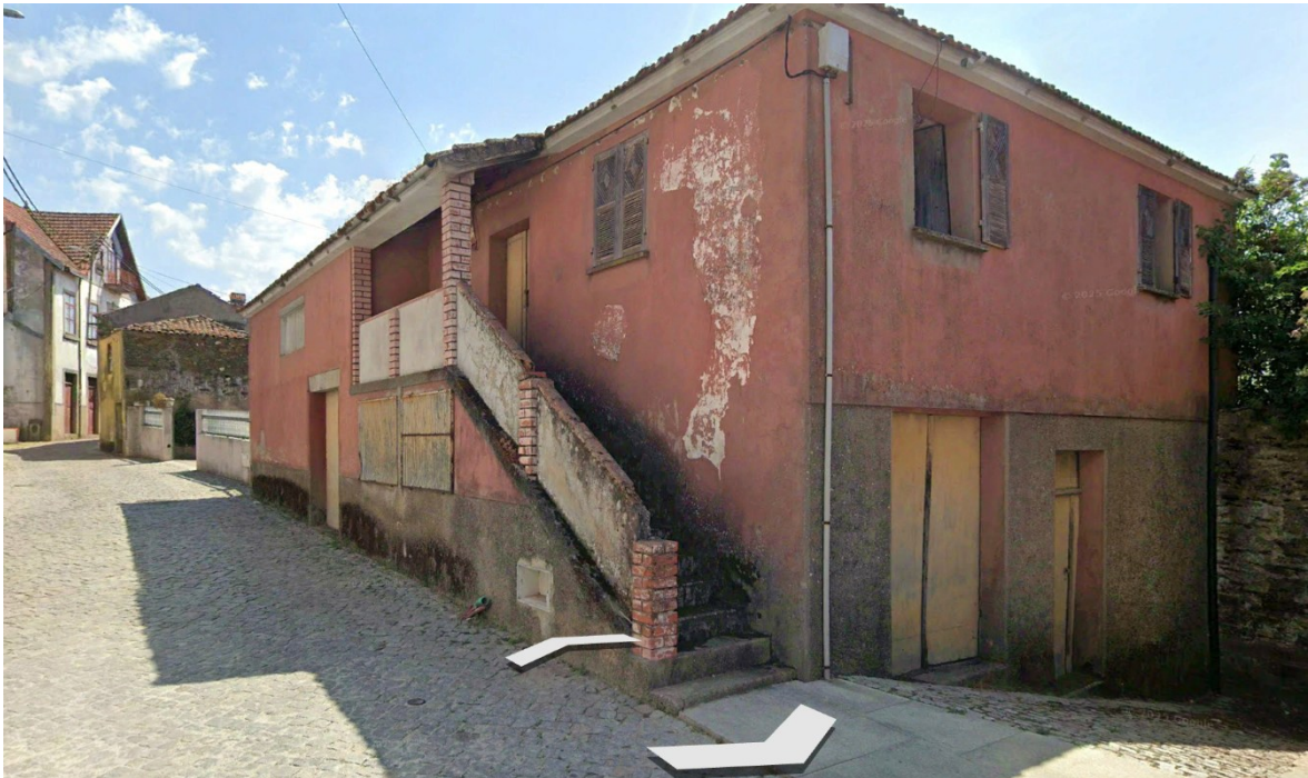
Figura 2. Exemplificação de edifícios degradados – Rua da Calçada
