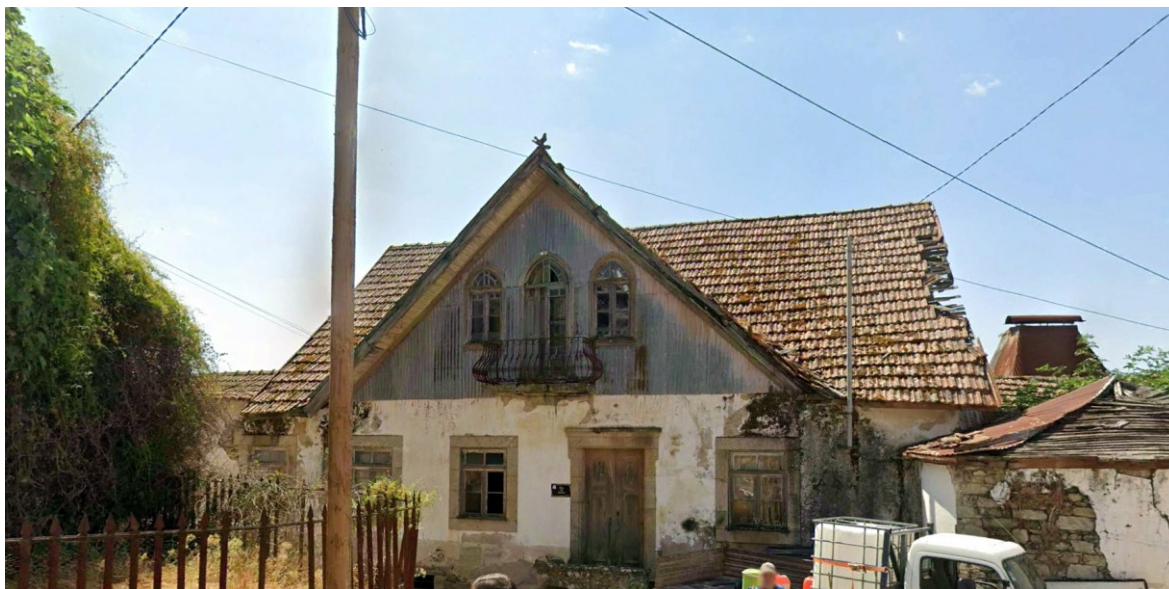
Figura 3. Exemplificação de edifícios degradados – Rua das Amoreirinhas
