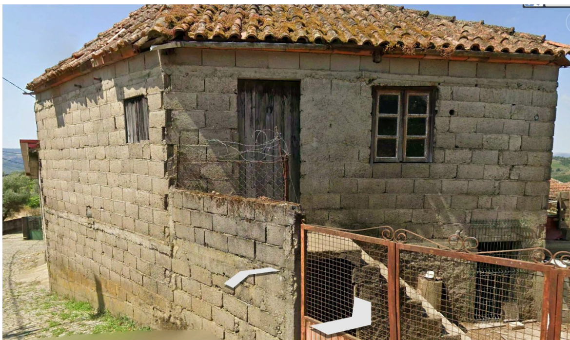
Figura 4. Exemplificação de edifícios degradados – Rua de Gadares
