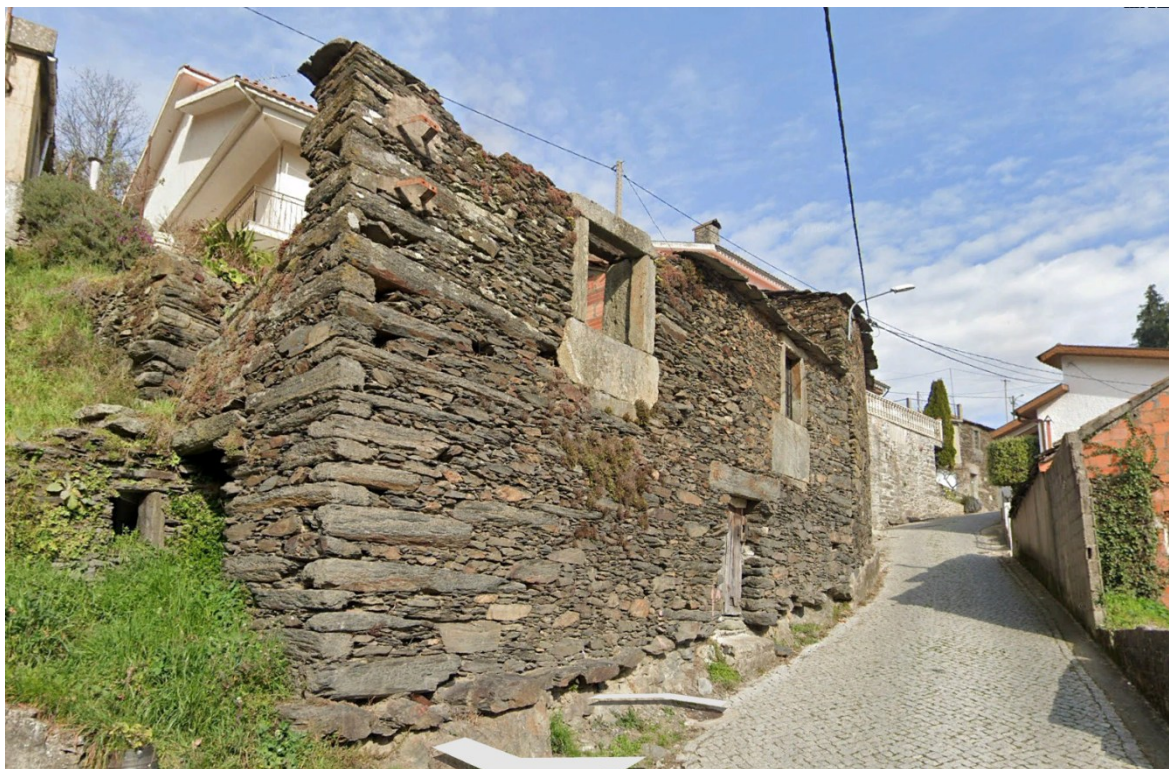
Figura 2. Exemplificação de edifícios degradados – CM 1307
