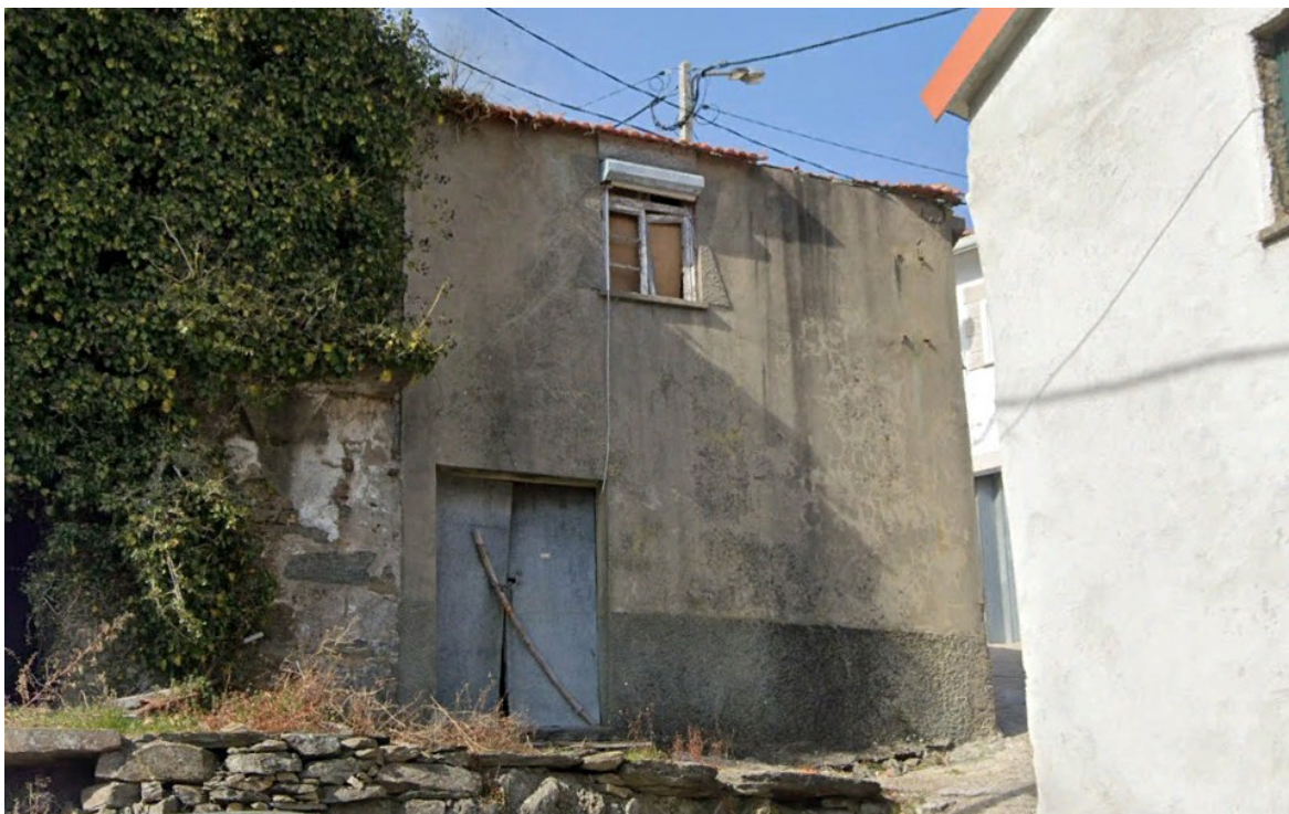
Figura 2. Exemplificação de edifícios degradados – Rua da Ermida de Cima
