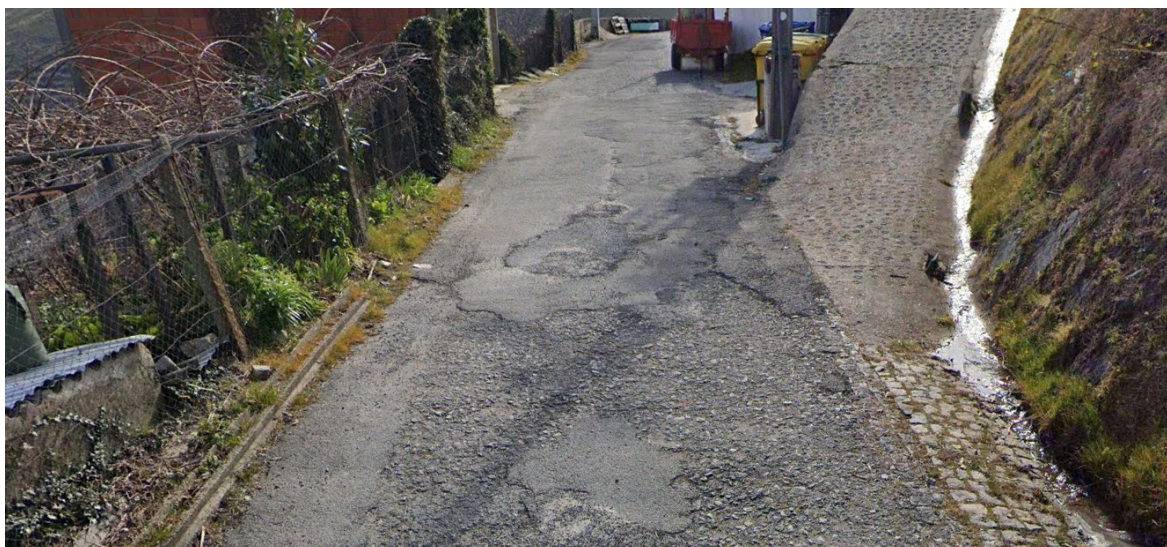
Figura 3. Exemplificação da existência de piso degradado na ARU de Ermida
