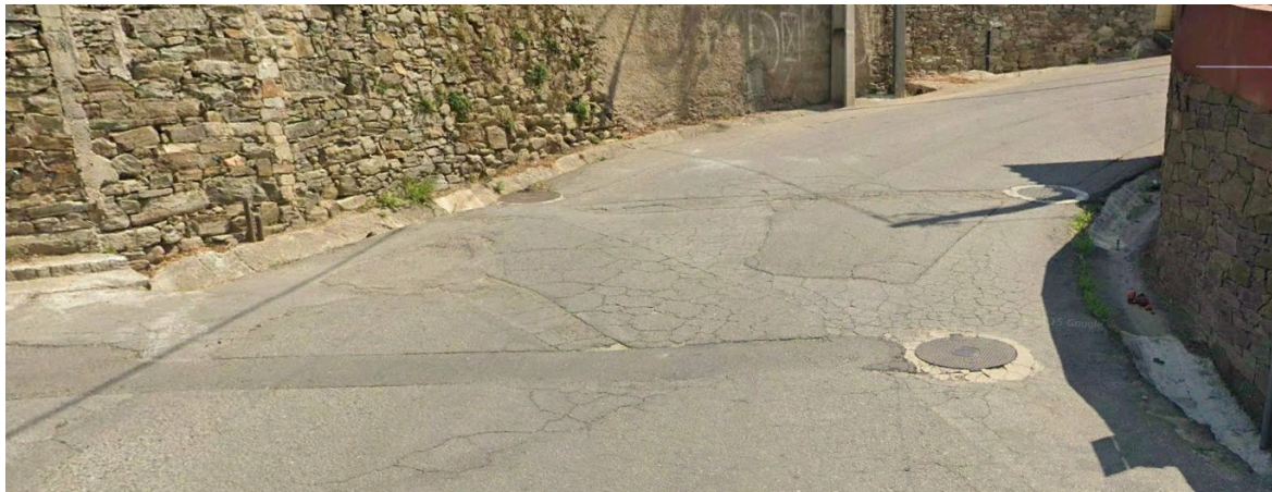
Figura 3. Exemplificação de piso degradado na ARU de Covelinhas – EN 131-1
