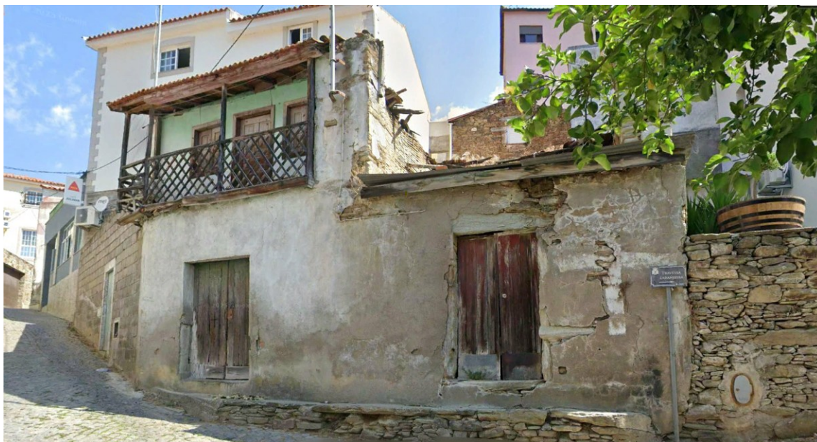
Figura 2. Exemplificação de edifícios degradados – Rua da Laranjeira
