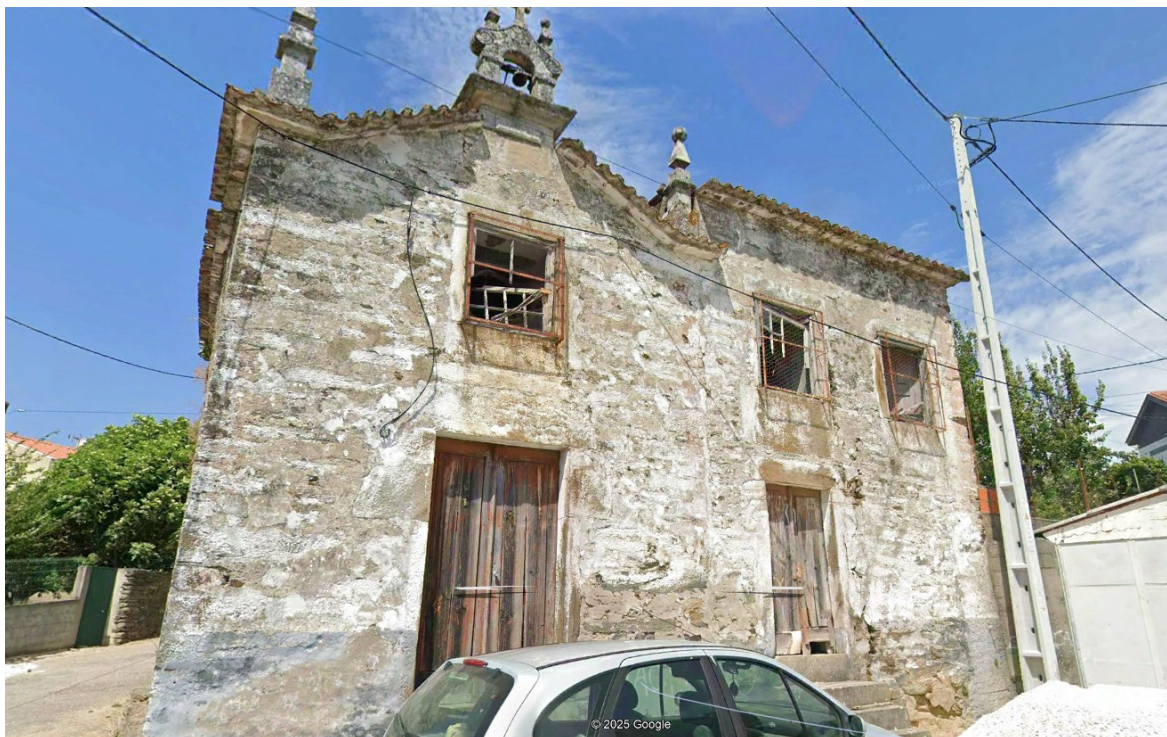
Figura 2. Exemplificação de edifícios degradados – Estrada de Cederma
