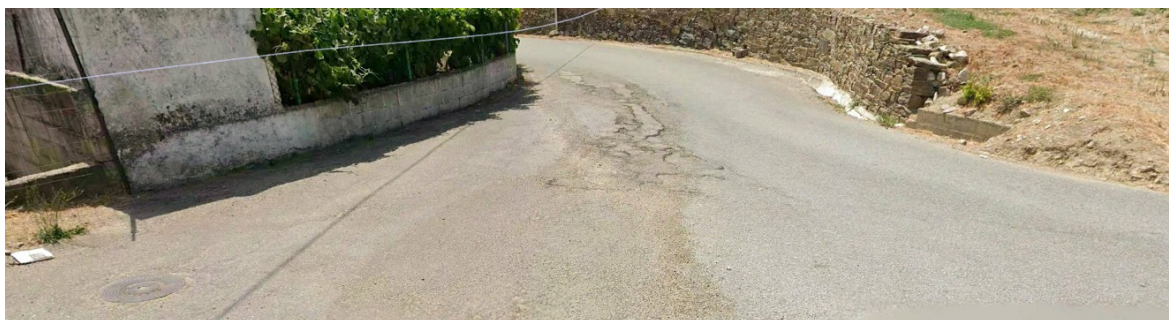
Figura 3. Exemplificação de piso degradado na ARU de Cederma – Estrada de Cederma
