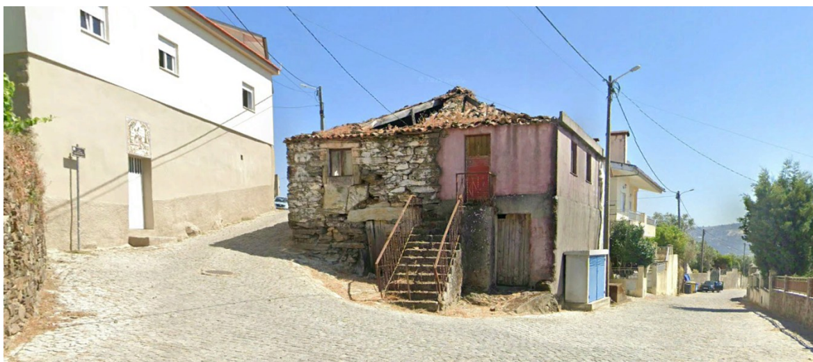
Figura 3. Exemplificação de edifícios degradados – Rua do Cabo
