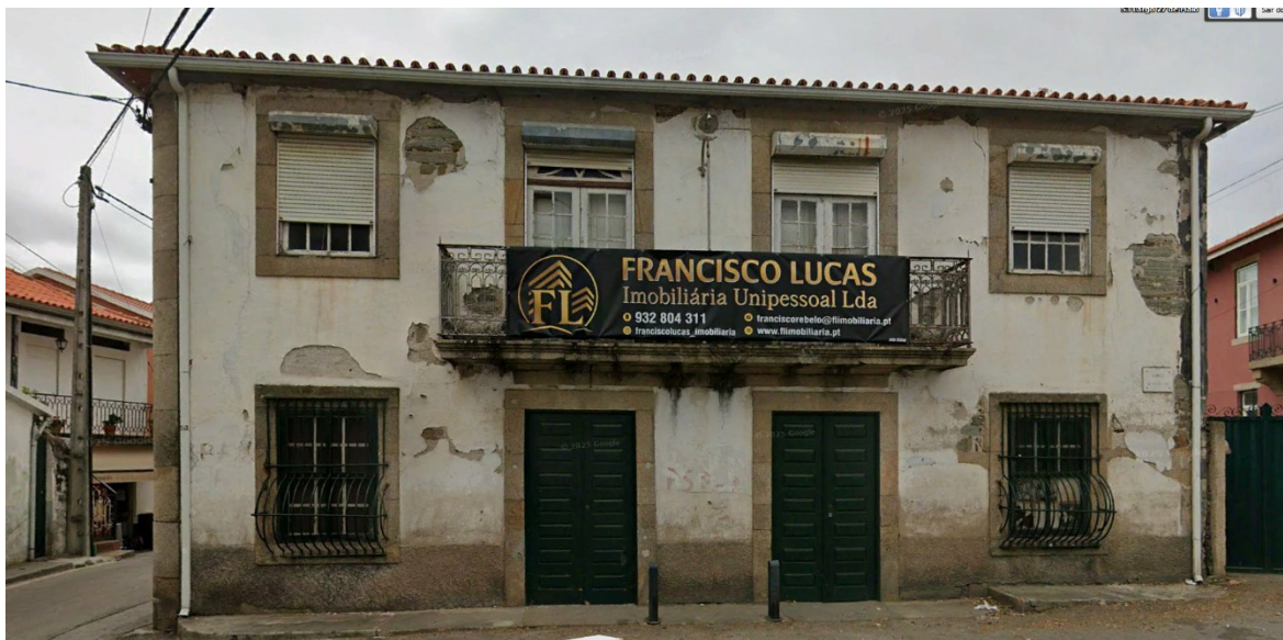
Figura 2. Exemplificação de edifícios degradados – Largo 27 de Maio
