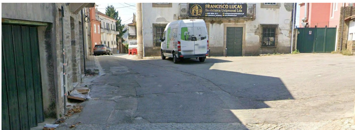
Figura 7. Exemplificação de piso degradado na ARU de Canelas – Largo 27 de Maio
