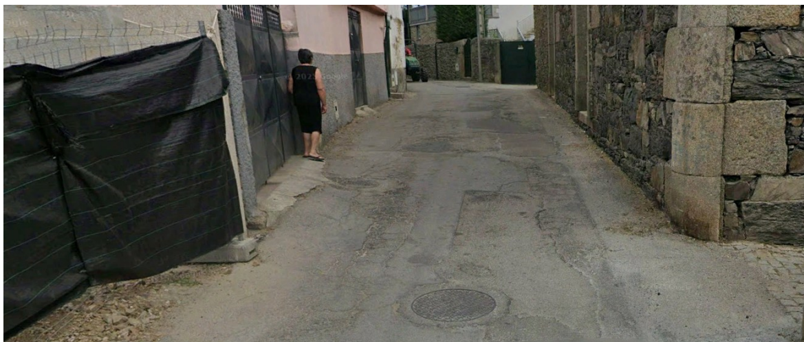
Figura 6. Exemplificação de piso degradado na ARU de Canelas – Rua do Vergado
