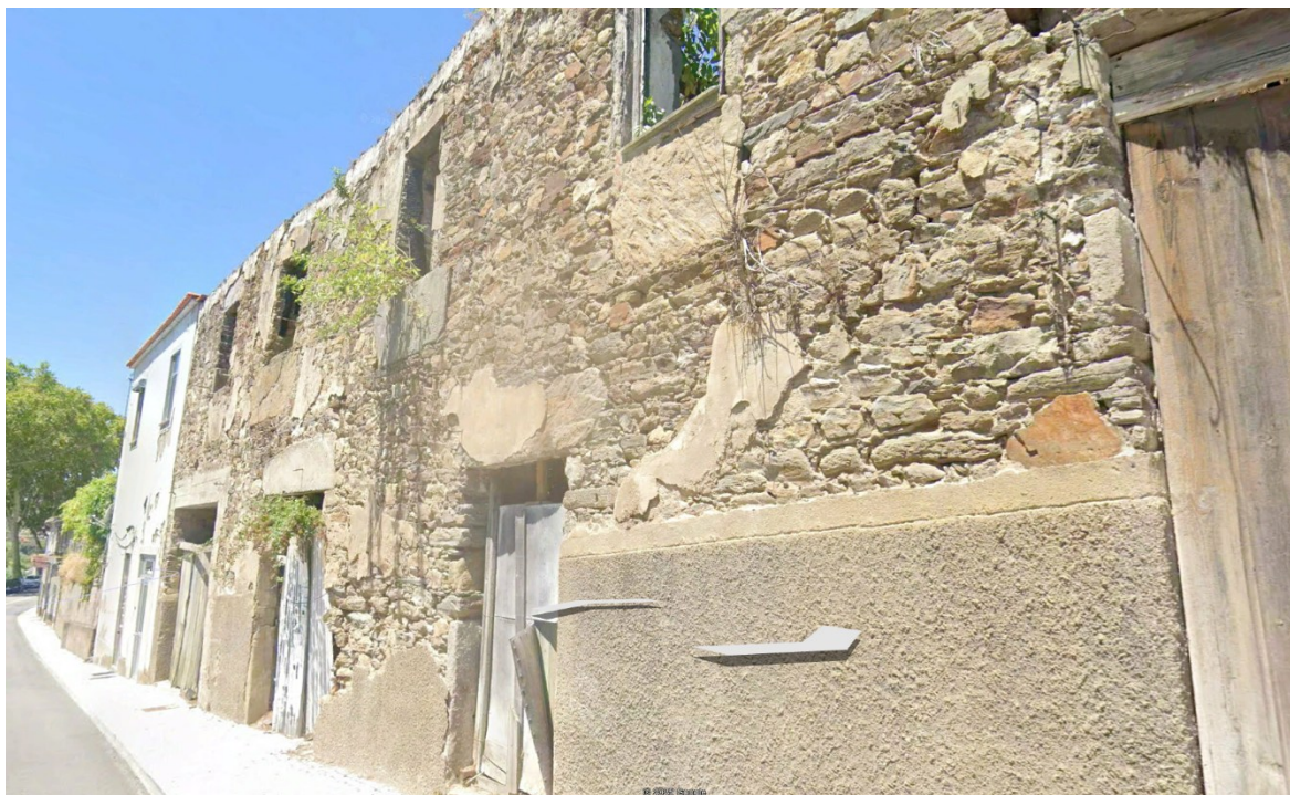
Figura 3. Exemplificação de edifícios degradados – Rua Dona Antónia Ferreira
