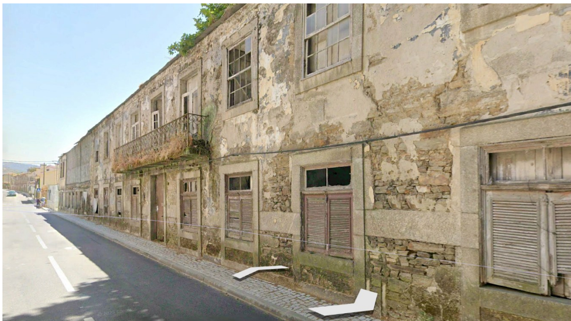
Figura 2. Exemplificação de edifícios degradados – Rua Dona Antónia Ferreira
