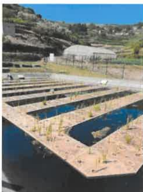
FOTO 4 - ETAR DE TABUADELO
