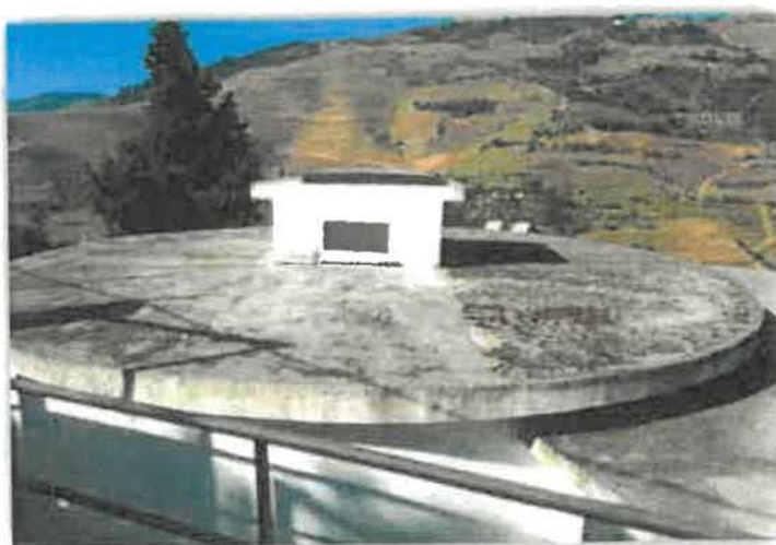
FOTO 2 - RESERVATÓRIO DE COVELINHAS
